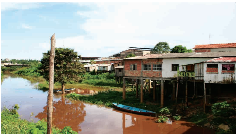
Figura 9 - Edificação com pilastras de concreto instaladas no leito do igarapé e fachada composta de alvenaria, em sua maior parte, com acréscimo em madeira. Fonte - Taissa Dias Barros, 2008.
