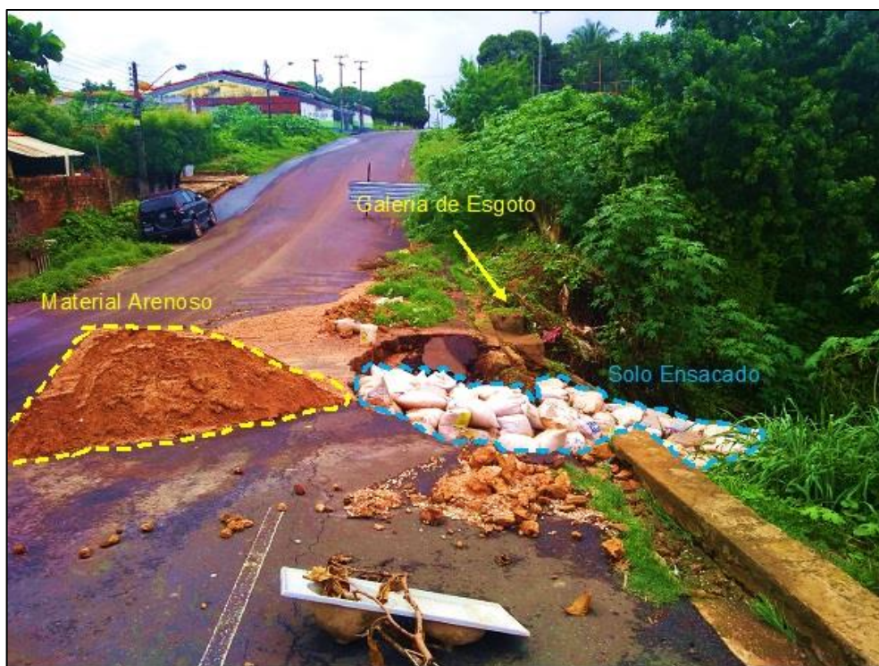
Figura 5. Depósitos Tecnogênicos Terrestres no bairro Satélite na sub-bacia PD07. Fonte: Os autores (2020). Rua danificada pela drenagem da água em um trecho de um riacho urbano, e utilização de solo ensacado para o reparo da rua.
