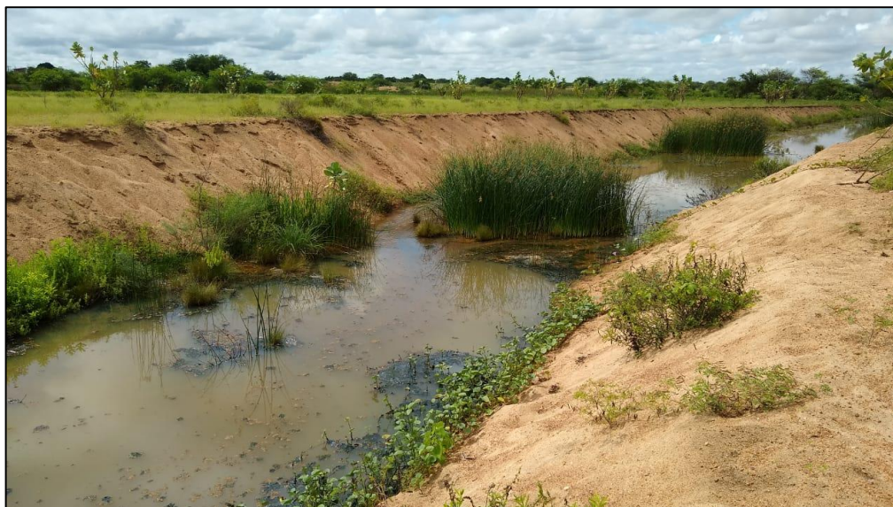
Figura 18: Canal do Piató - Trecho próximo a ligação entre o canal do Piató e o Rio Piranhas que necessita (2019) de manutenção. Fonte: Rocha (2019).
