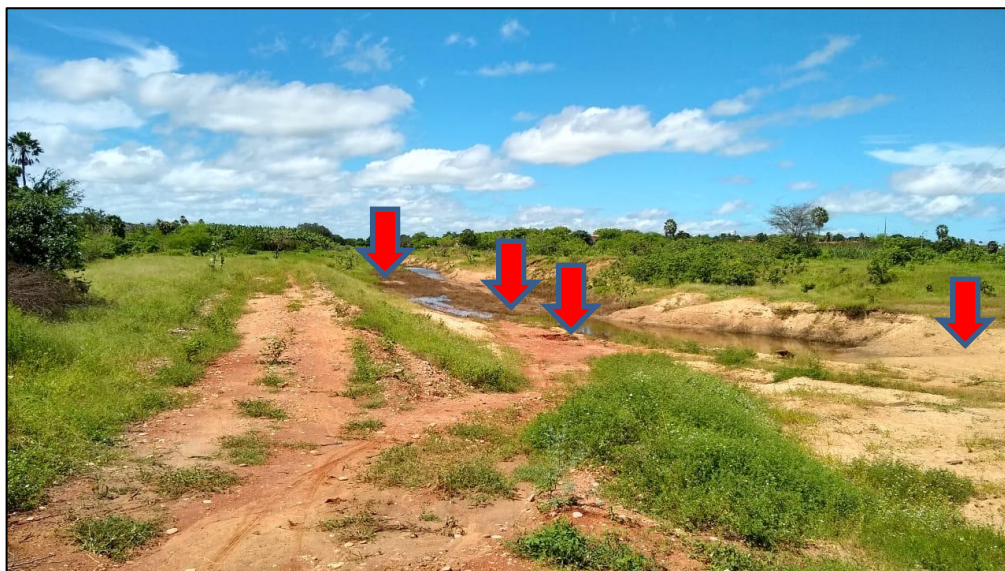
Figura 3: Acumulo de sedimentos no canal. Fonte: Rocha (2019).
