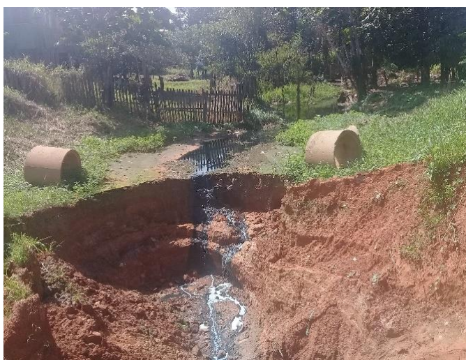
Figura 12 – Processo erosivo ocasionado pela deficiência de drenagem do esgoto no bairro Cidade Nova. Fonte: Registrado pelos autores, dezembro de 2019.
