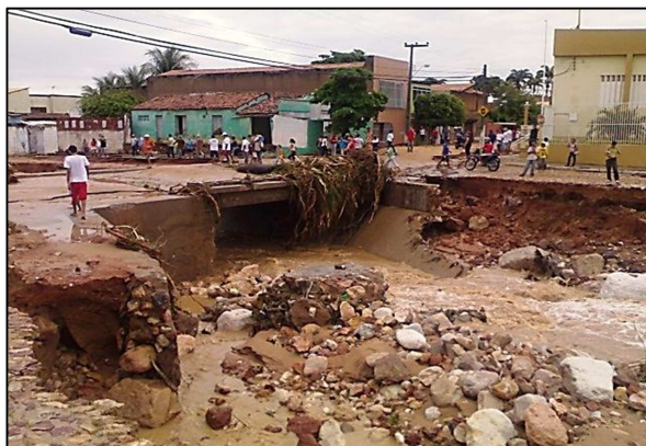
Figura 2: Destrução de parte do canal do rio Grangeiro. Crato – CE, 28 de janeiro de 2011.
