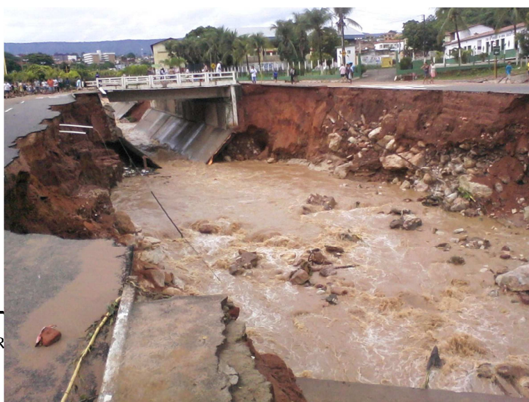
Figura 03: Canal do rio Grangeiro destruído pelo forte volume de água do rio
