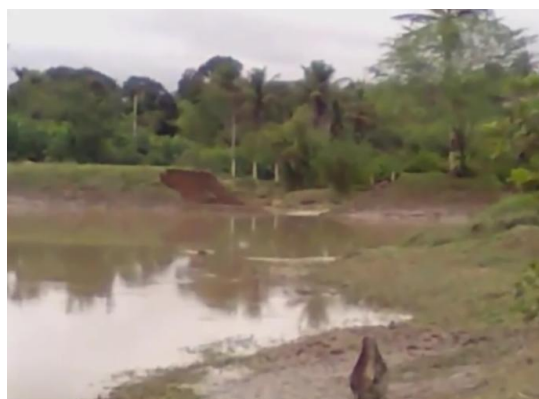
Figura 5 - Barragem de barreiros rompida. (Lagoa Seca-PB) (Foto Acervo Paulo Rosa, Data: 18.07.11).
