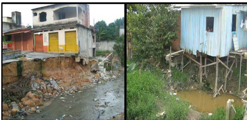
Imagem. 1- Ocupação de risco as margens do Igarapé do Mindú Fonte: Adriana Sá, em 21-04-2011
