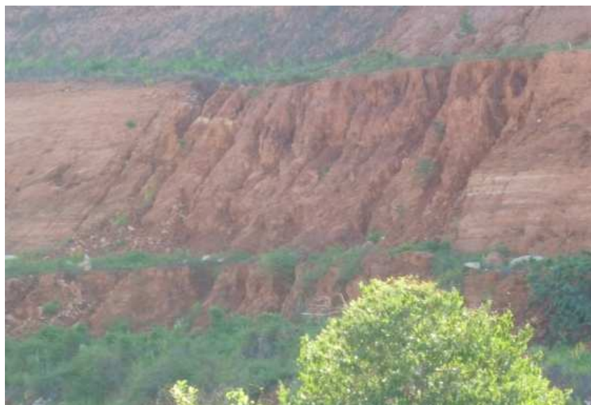
Figura -5- Talude próximo a ombreira esquerda com início de voçorocamento.
