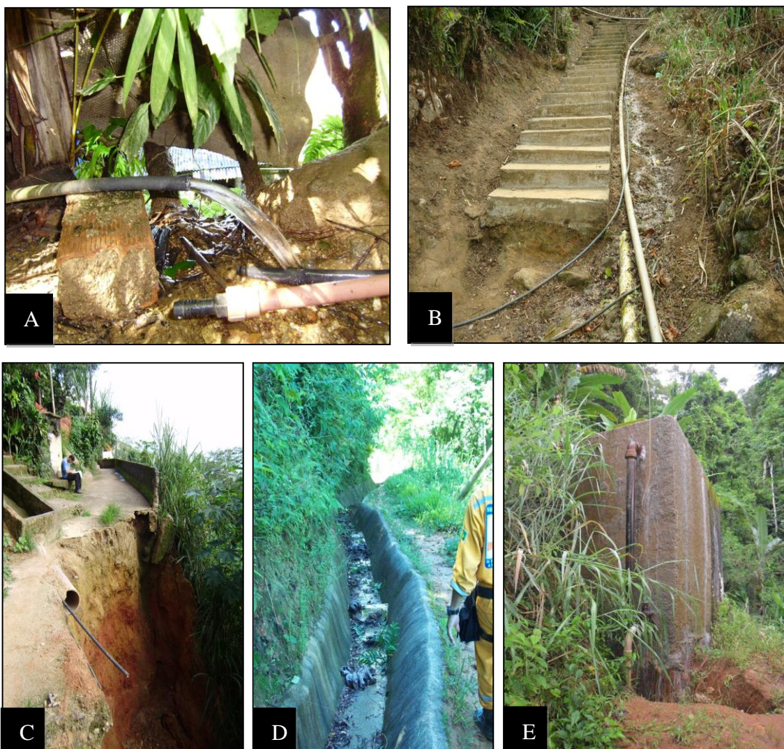
Fig. 3. Sistemas urbanos de drenagem levantados em campo. A - saída d'água; B - escada de acesso; C - cano rompido; D - canaleta; E - vazamento em cisterna e caixa d'água = ponto de interesse (POI).
