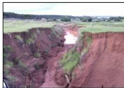
Figura 6 - Um dos pontos mais críticos da erosão urbana. Foto: Vallin (2010)
