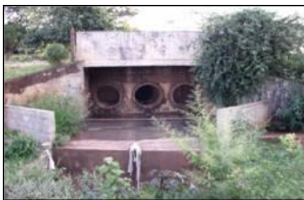
Figura 5 - Galeria de águas pluviais na chácara Santo Antônio, agravante da erosão urbana. Foto: Vallin (2010)
