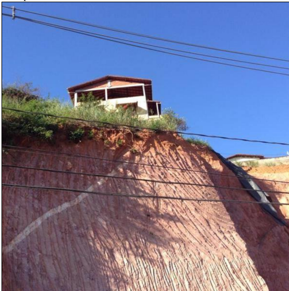
Talude com corte aproximado a noventa graus com residência em risco.
