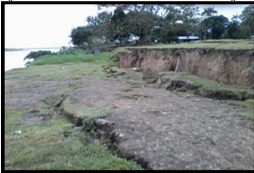
Ocorrência de abatimentos de solos, evento precedente aos movimentos de massas que levam os sedimentos ao rio.
