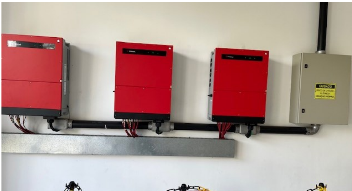
Figura 2. Inversores Goodwe. Usina Fotovoltaica FCA-UFAM. Fonte: O Autor
