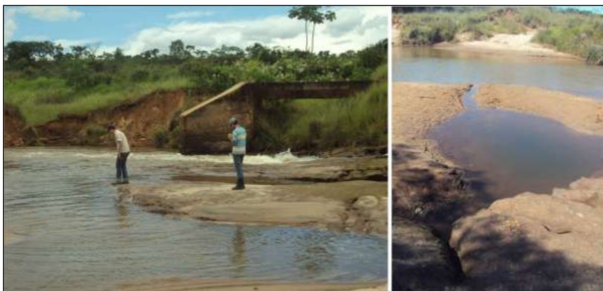
Foto 01: Processos erosivos e assoreamento da drenagem principal da Bacia Hidrográfica do Ribeirão da Picada-GO. Autora: Régia E. Alves. Trabalho de campo realizado em 27/01/2011.
