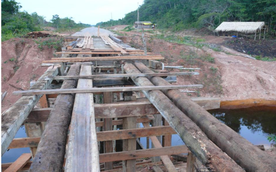
Fig. 03 – Uma das pontes da BR-319 mostrando as precárias condições de circulação Foto: Marcos Castro, dezembro/2007
