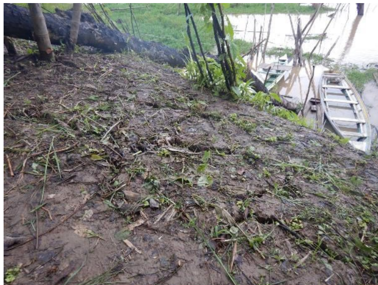
Figura 5. Rachadura na margem da comunidade em fevereiro de 2022. Fonte: Acervo dos autores (2022)
