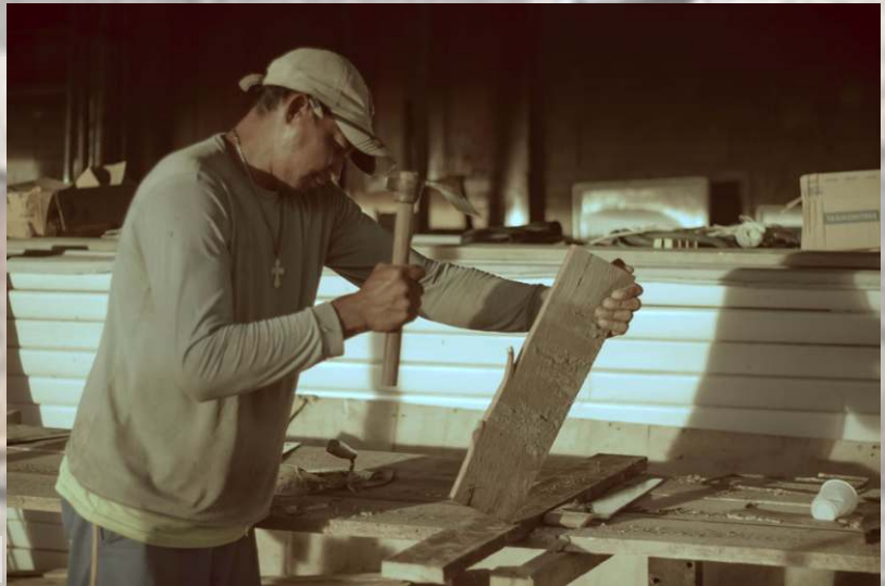
Foto 37. Sem luvas e óculos de proteção.
