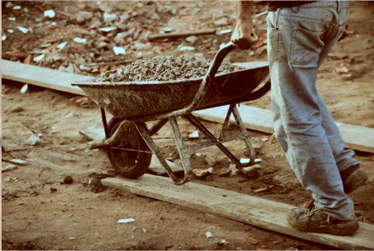
Foto 36. Trabalhador sem botas apropriadas.
