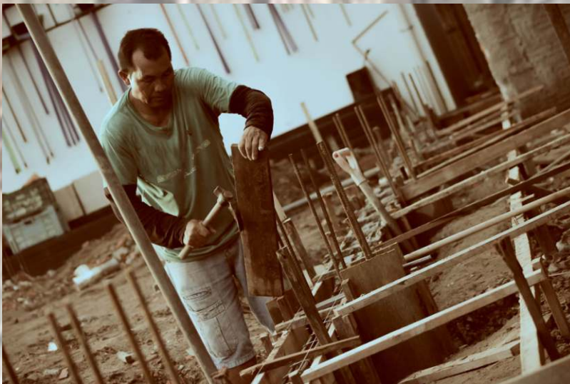
Foto 38. Trabalhador sem capacete protetor.
