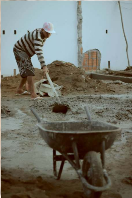
Foto 11. Todo equipamento de proteção individual deve e precisa ser adequado ao trabalho realizado pelo empregado.
