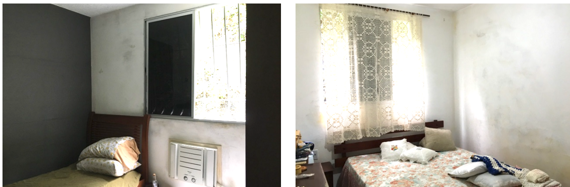
Figura 2 e 3 – Fotografias quartos com presença de mofo nas paredes
