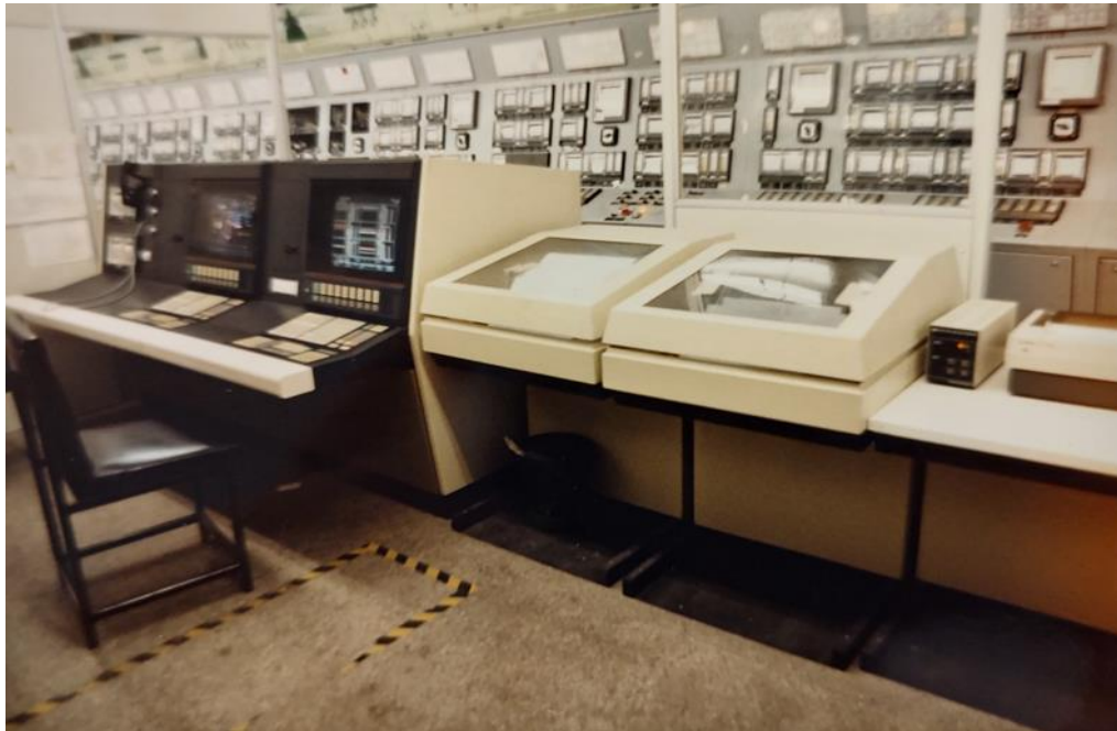
Figura 14 – Fotografia dos painéis SDCD da área modernizada da sala CEMAP-1
