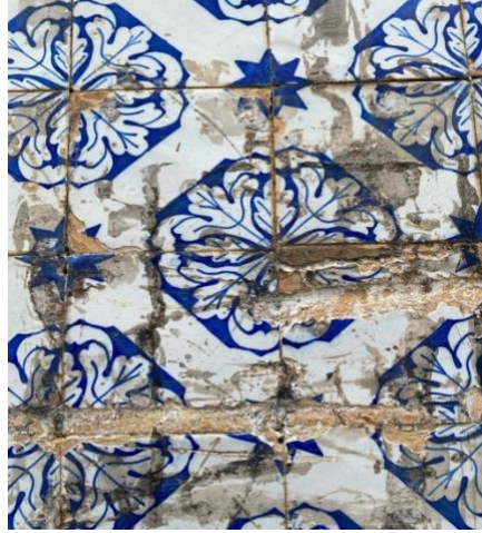
Figura 15: Exemplo de azulejo em estado deterioração na Rua da Estrela
