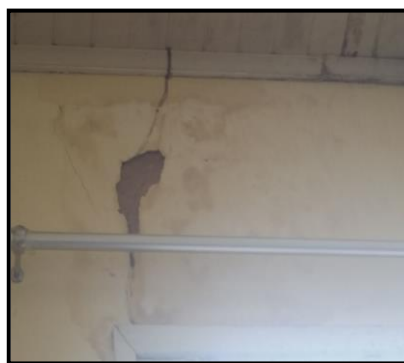
Imagem 10 – Infiltração, desagregação e mofo
