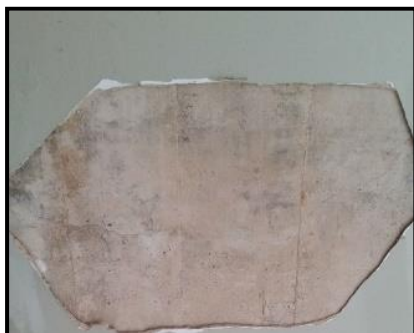
Imagem 3 – Desagregação com descolamento do revestimento
