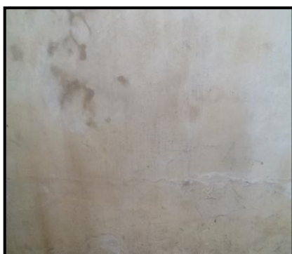
Imagem 9 – Infiltração e mofo
