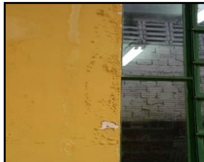
Imagem 4 – Umidade de Infiltração
