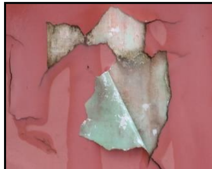
Imagem 2 – Descamação e mofo da pintura
