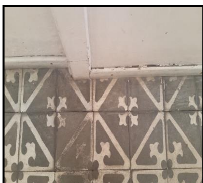
Imagem 11 – Manchas e deterioração
