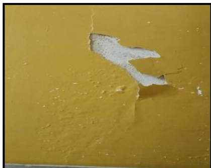
Imagem 1 – Gretamento e descolamento do revestimento
