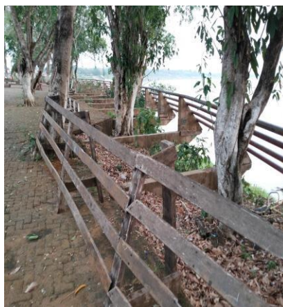
Figura 6: Deck destruído pela enchente do rio Madeira
