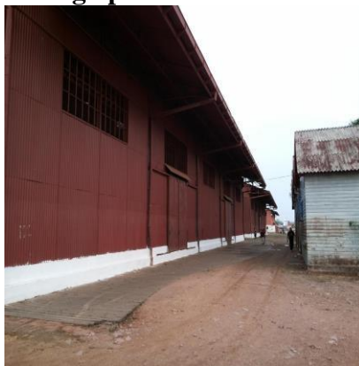
Figura 5: Vista de um dos galpões da ferrovia com seu deck deteriorado
