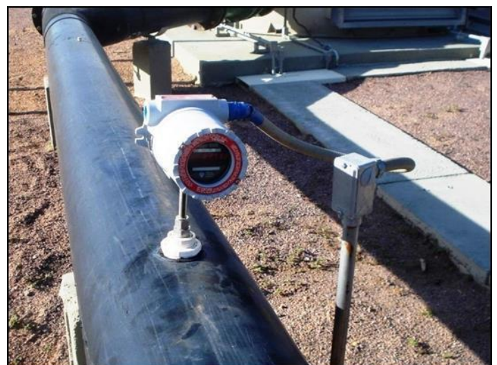
Figura 9: Medidor de Vazão de LFG.
