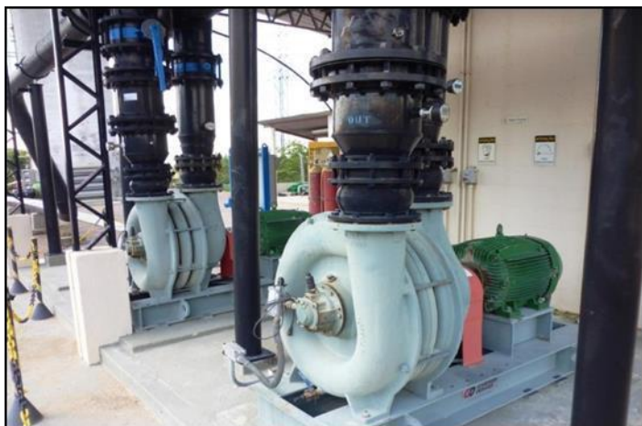
Figura 7: Conjunto de Sopradores.
