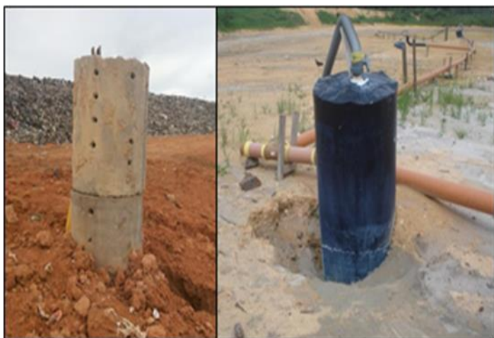
Figura 3: Dreno vertical antes e após ser conectado ao sistema de coleta. Fonte: Autor, (2018).
