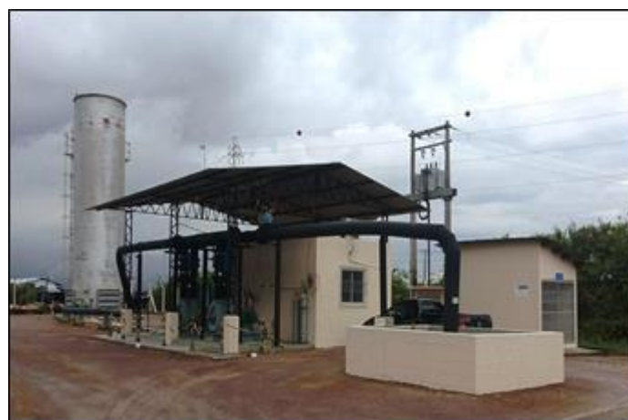
Figura 2: Planta de Captação e Queima de Biogás do Aterro de Manaus.
