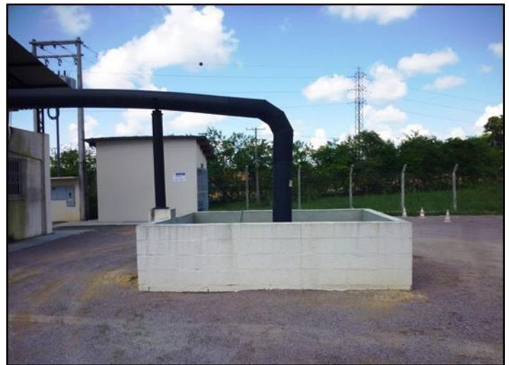
Figura 6: Caixa de remoção de condensado. Fonte: Autor, (2018).
