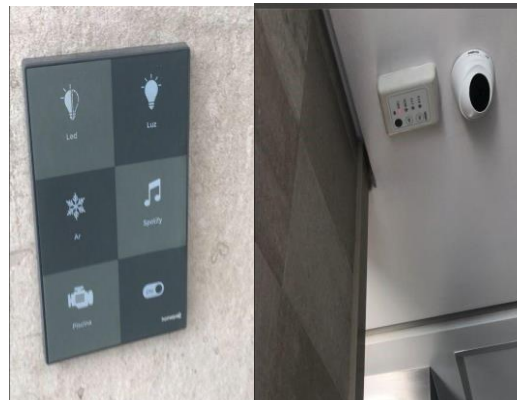
Figura 3 – Teclado SmartPad e Ar condicionado instalado no teto de uma residência que possui Automação
